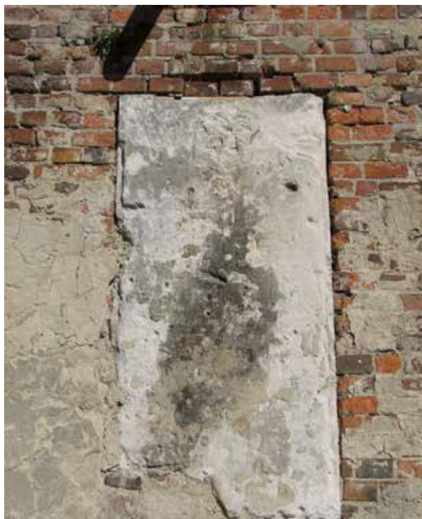
Stan płyty jeszcze przed demontażem jej z fortu Stern i przed wykonaniem prac ratowniczych (Fot. DAC)
